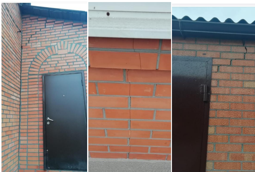
Рисунок 1 – Формирование трещин в новых зданиях
