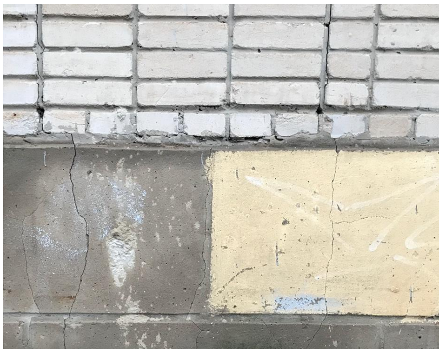
Рисунок 2 – Раскрытие трещин в эксплуатируемых зданиях
