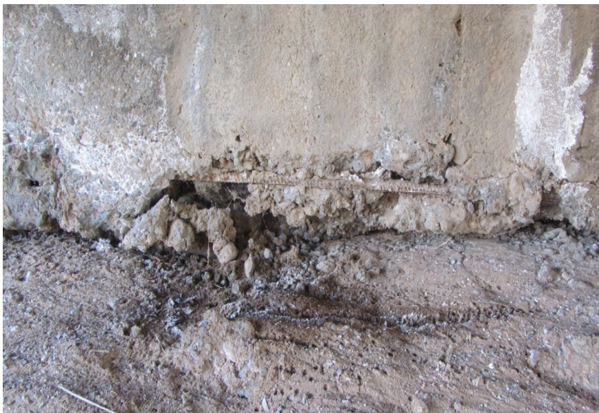
Рисунок 2. Оголение и коррозия арматуры опор
