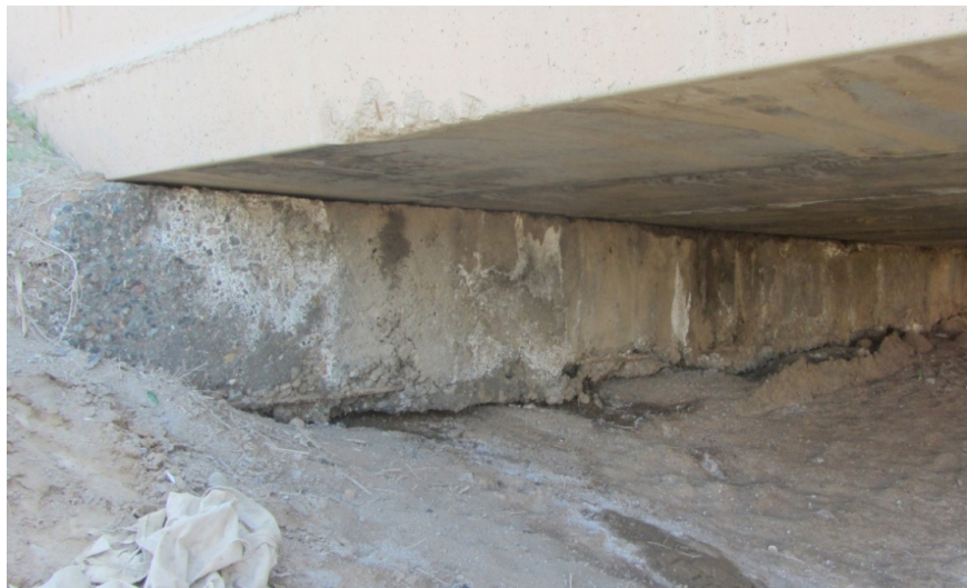
Рисунок 1. Следы выщелачивания и коррозии бетона насадки опор
