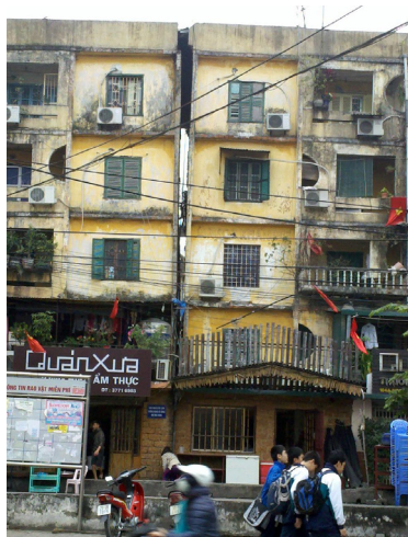
Рисунок 1. Неравномерные осадки зданий в микрорайоне Жангво в 2012 г. [8]
