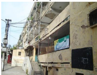
Рисунок 8. Неравномерные осадки зданий в районе Зангво центра Ханоя
